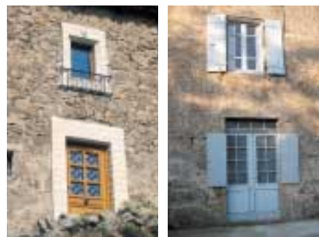
À ÉVITER, placage de pierre en encadrement.
