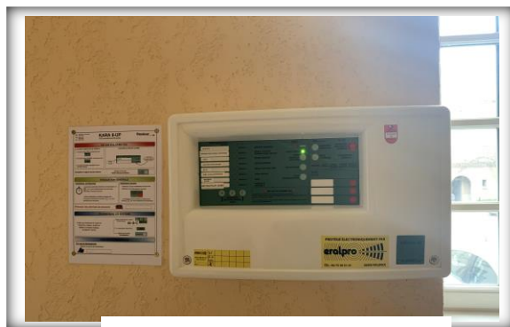
Système de sécurité incendie
